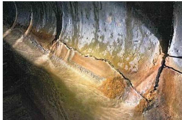
Längs- und Quer-Risse im Durchlass Hochstudenbach
