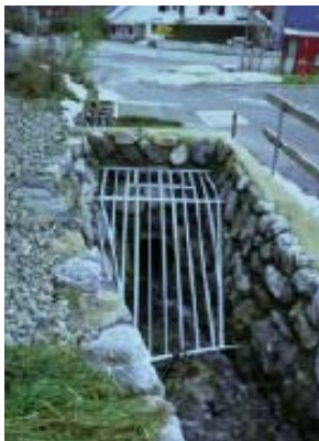
Beispiel einer Schutzmassnahme am Seckibach
