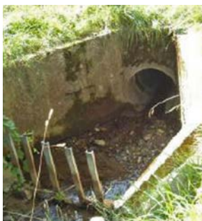
Beispiel einer sanierungsbedürftigen Massnahme am Stadelwiesbach
